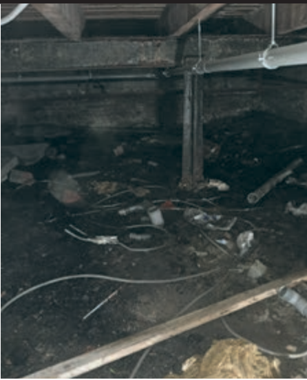
Bij een renovatieproject van een schoolgebouw in Rotterdam waren de houten vloerbalken zo vochtig waren dat de aannemers niet aandurfd met het aanvankelijk beoogde materiaal te isoleren.
